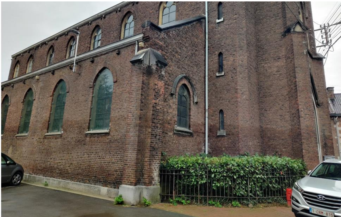
Billede 2: Kirke i Trooz, hvor man tydeligt kan se vandets maksimale højde. Man kan stadig på flere bygninger se hvor vandstanden gik til og hvordan fugten i bygningerne stadig holder ved. Kirken er endnu ikke i brug, men fungerer som mødested for frivillige, der stadig kommer til området og hjælper med oprydning og renoveringsarbejde (Feltbillede).
