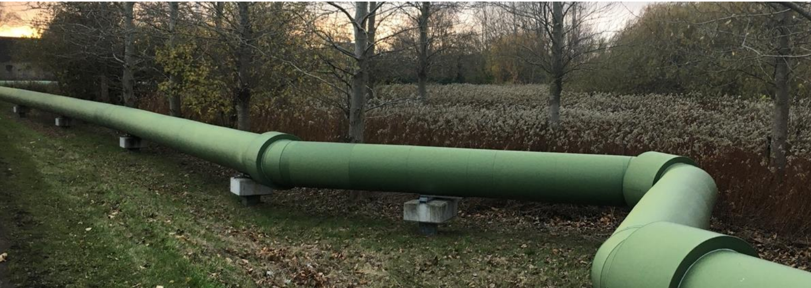
BILLEDE 4 – DE GRØNNE RØRFØRINGER I KALUNDBORG BY DER DISTRIBUTUERER DAMP FRA ASNÆSVÆRKET (EGET FOTO).
