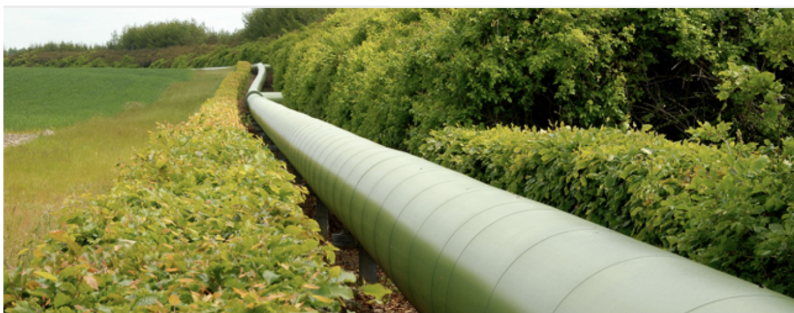
Figur 9: De grønne rør som fører reststrømme, kan ses mange steder i Kalundborg (Kalundborg Kommune, 2020b)
