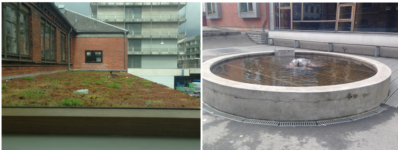
Billede 5: Ekstensivt tag på Tove Ditlevsens Skole og Billede 6: Bassin i skolegården på Tove Ditlevsens Skole
